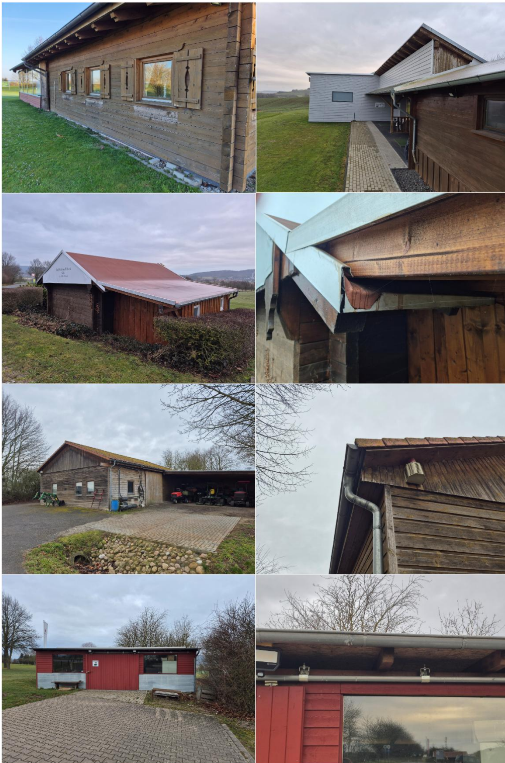
Abb. 8: Die Gebäude im Eingriffsgebiet weisen jeweils durch Spalten und Nischen ein hohes Quartierpotenzial für gebäudebewohnende Fledermäuse auf. Oben links das Haupthaus (ID 1) mit Fensterläden und Spalten am Dachtrauf. Oben rechts das Ballhaus mit Gerätehalle (ID 4), an der Blechattika und Dachüberstand potenzielle Quartierstrukturen bietet. Zweite Reihe von oben: kleines Versorgungsgebäude (ID 2) mit Spalten an Blechattika und Dachtrauf. Dritte Reihe von oben: Werkstatt mit Scheune (ID 3), die dauerhaft zugänglich ist und Spalten an Dachtrauf und unter Ziegeln aufweist. Untere Reihe: Werkstatt (ID 5), die über die Dachkonstruktion dauerhaft zugänglich ist.
